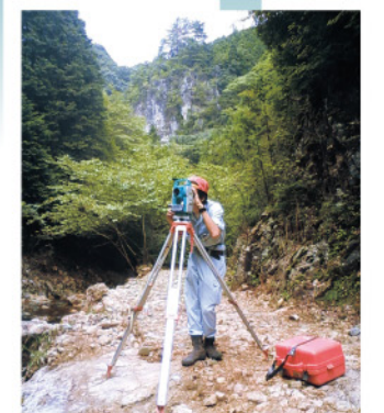
林道菅町線 災害復旧
